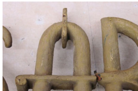
4. ábra Előtűnő vaskorróziós termékek
