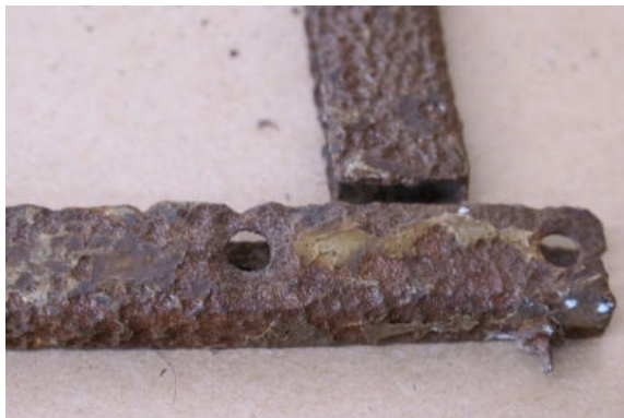
5. ábra A korrodált keret részlete
