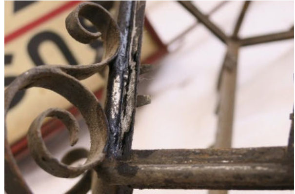
7. ábra A kandaláber több elemén is átfestés található
